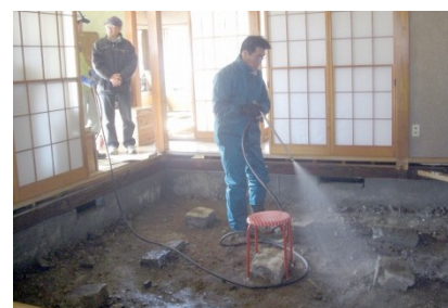
床下のカビ臭対策にEM散布
